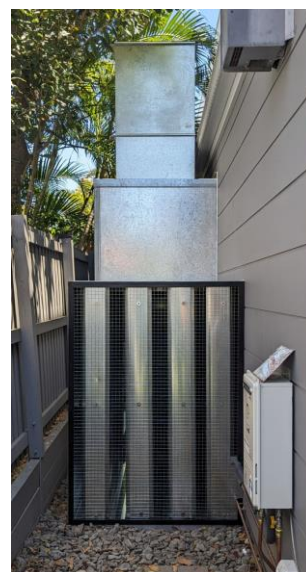
(d) 25 kW condenser with enclosure
